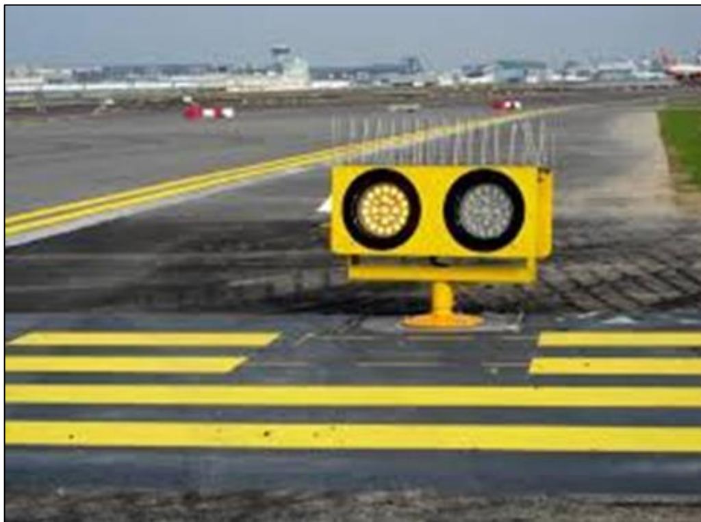
Figura 5 – Luz de Indicação de Área de Movimentação em Operação
