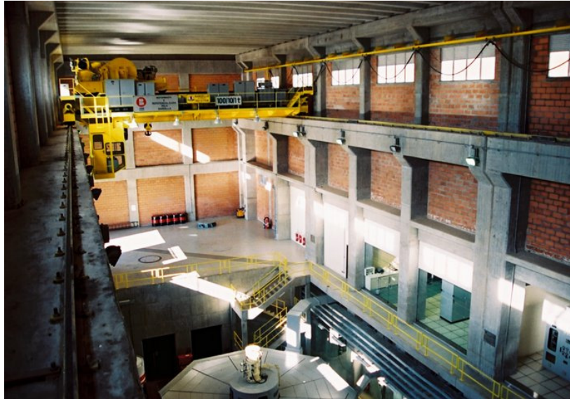
Figura 6 - Vista interna da casa de força
