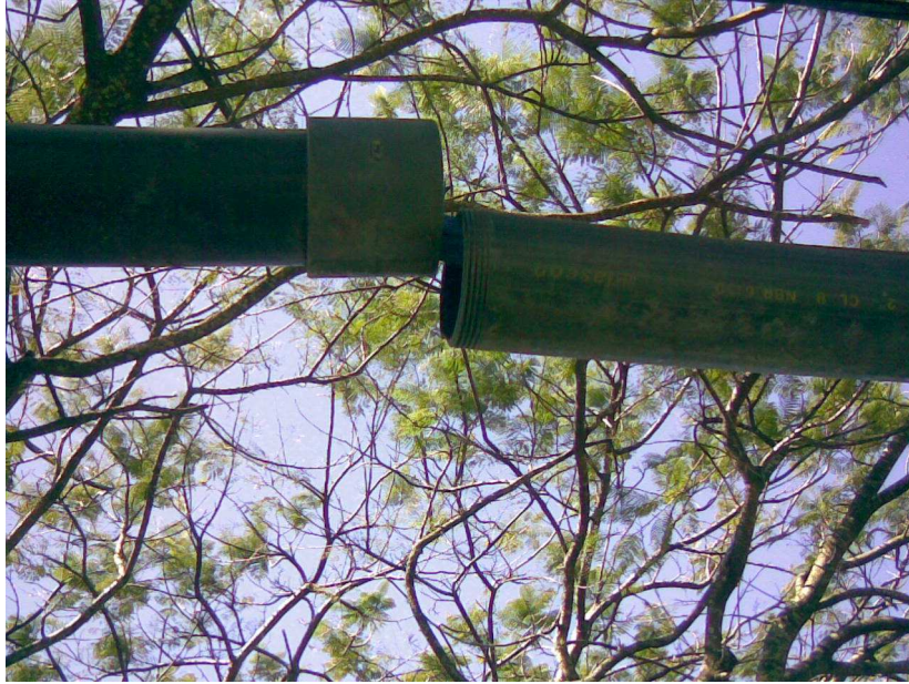
Figura 3-1: Cabeamento externo exposto ao tempo e ataques físicos
