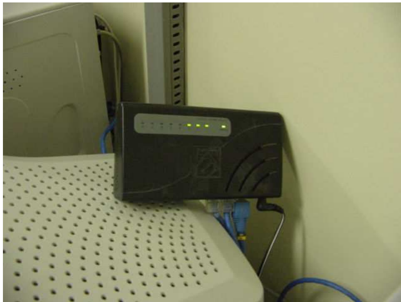
Figura 3-2: Switch não gerenciável instalado de forma irregular
