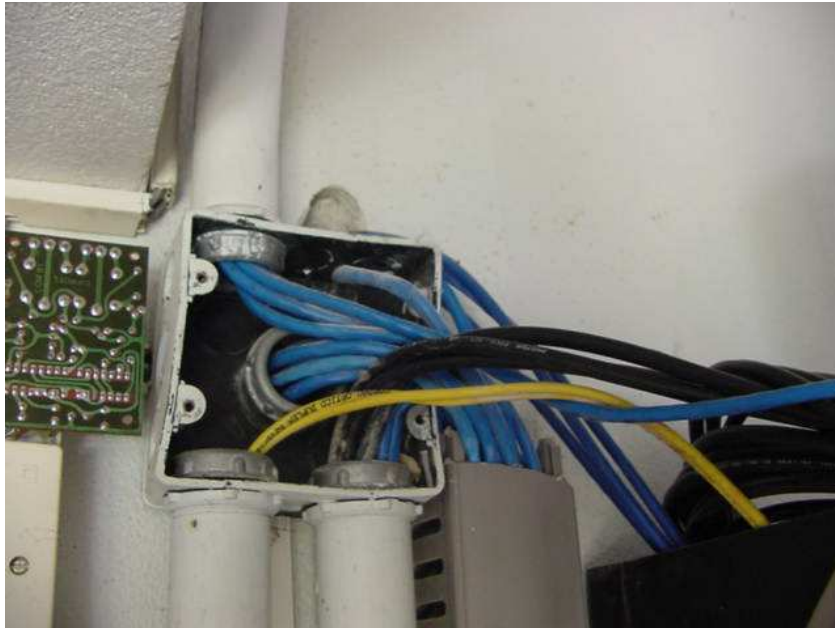
Figura 3-6: Exemplo de instalação incorreta de cabeamento elétrico e de dados
